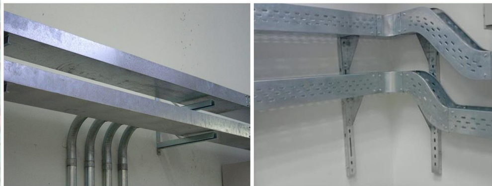
Figura 7 - Exemplo de Eletrocalhas Sobrepostas
