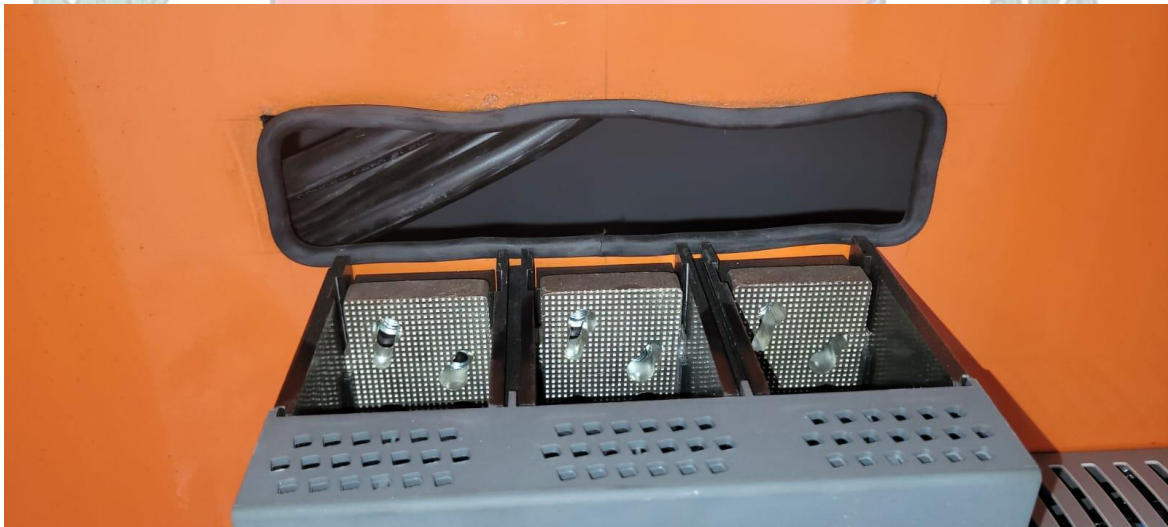
Figura 5 - Passagem para Barramentos Existente
