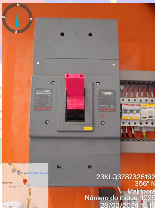
Figura 1 - Disjuntor 1600A Existente
